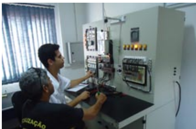
Agentes da AEM-MS realizam a verificação dos medidores de energia
